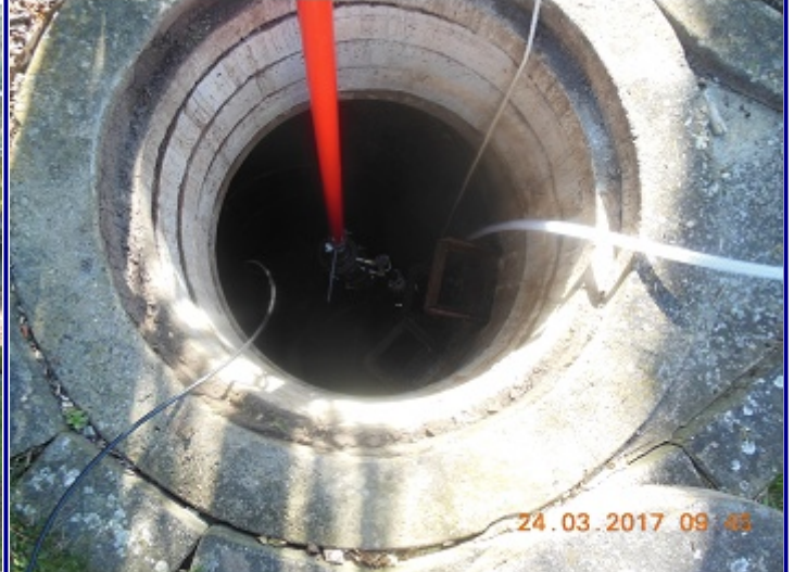
Schacht an GG
